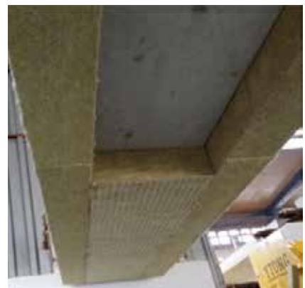
Brandskydd på undersidan av balken.
